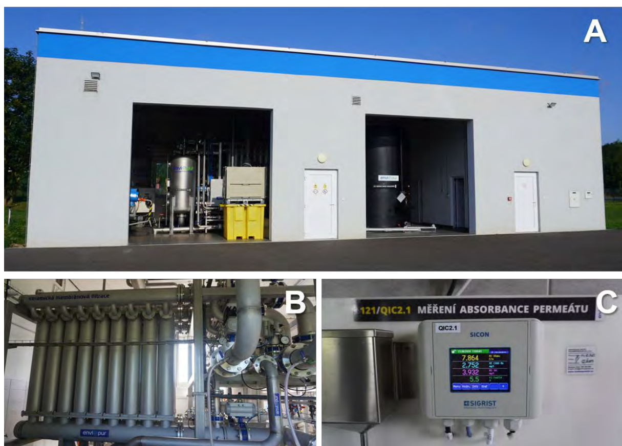
Obř. 1. Celkový pohled na objekt úpravný vody pro Velký bolevecký rybník (A), detailní pohled na technologii keramických membrán - vlevo housingy jednotlivých membrán, vpravo armaturní část technologie (B), převodník kontinuálního měření absorbance permeátu (C)
